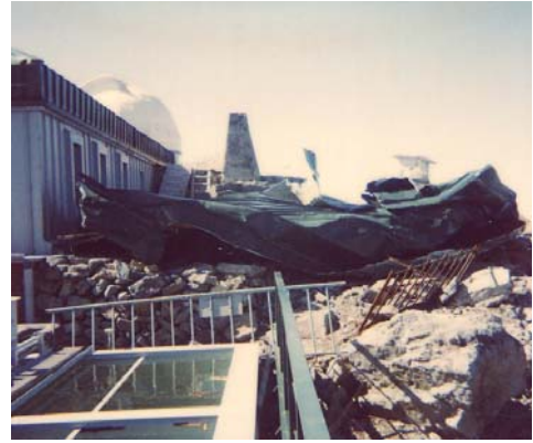
（分光室北窓まで飛ばされたトタン屋根）
