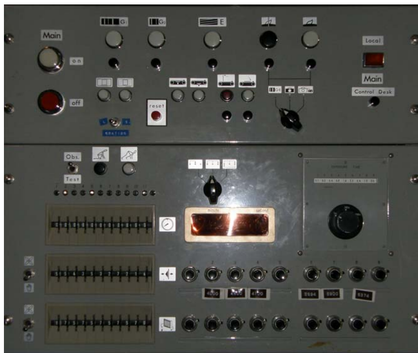
分光器制御盤
